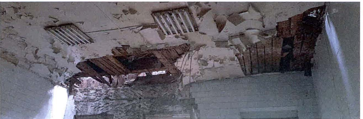
Az épület jelenleg életveszélyes: a tetőfedés és a bádogozás hiányos, a földém több helyen beszakadt.
