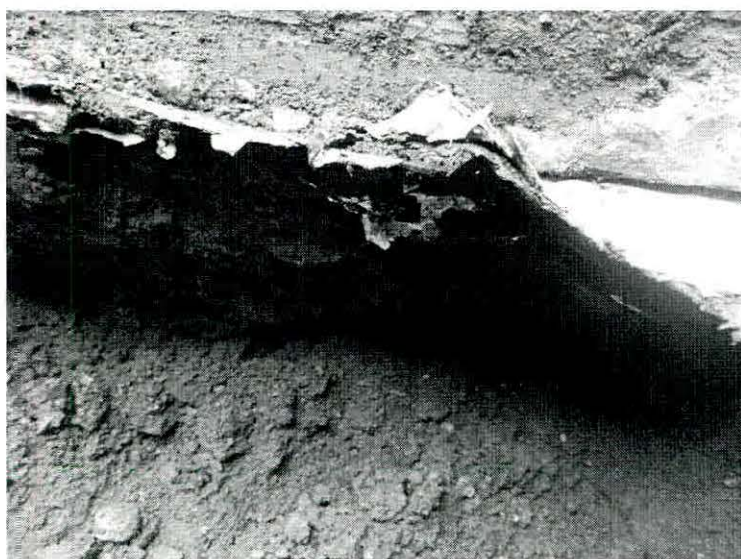
24. kép A szigetelésvédő fal, a vízszigetelés a talpgerendák készítésekor létrejött betonmegfolyásról indulnak.
