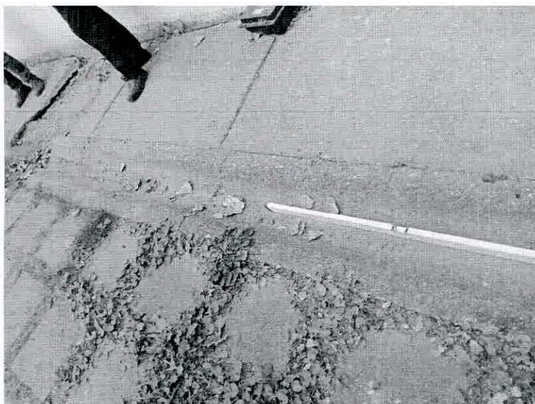
19. kép A B épület és a büfé épület közti járdaszakasz. A folyóka lejtése elégtelen. A járdaszakasz megsüllyedése miatt egy-egy helyen ellenlejt.
