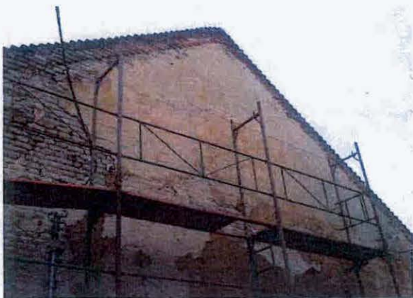
7. kép; Leromlott állapotú oromfal
