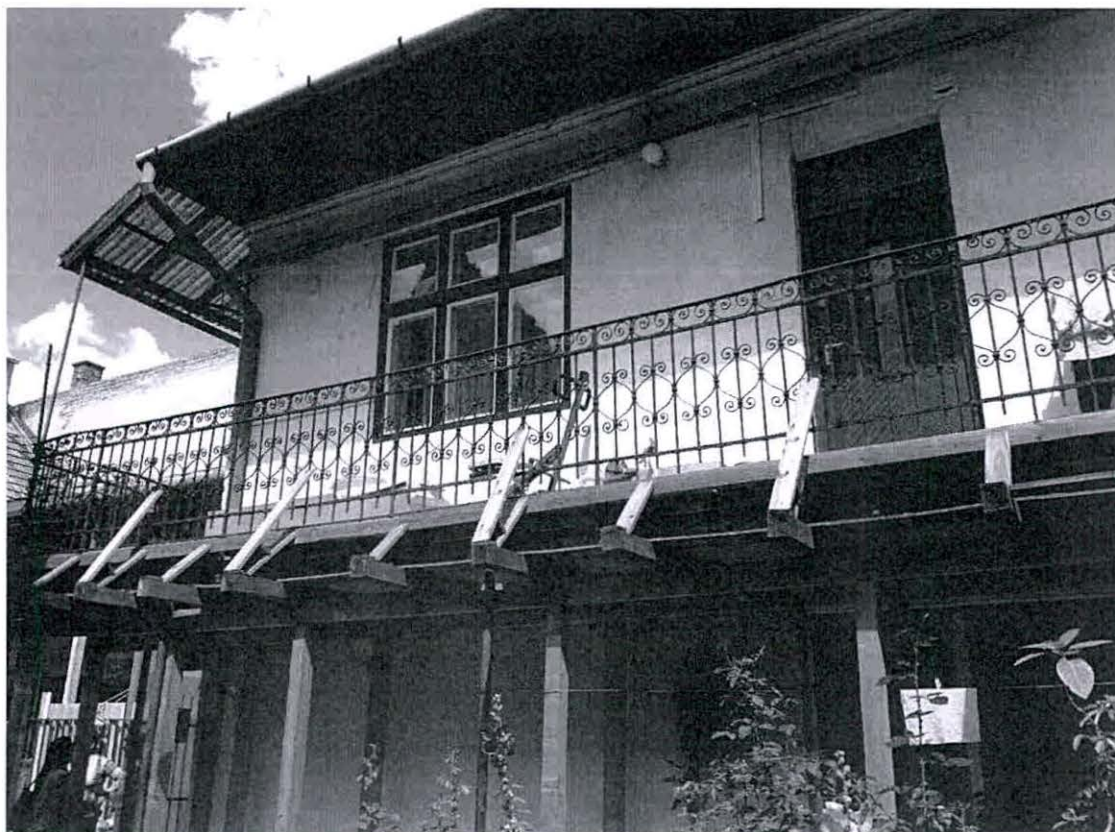
2. ábra Veszélyeztetet épület udvari homlokzata
