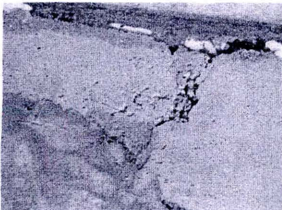
9. kép Fészkes beton
