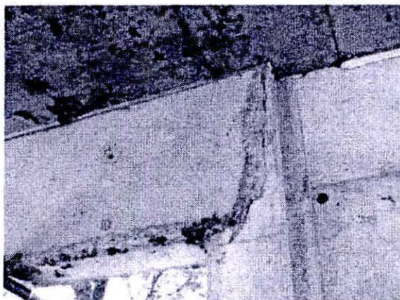
11. kép Szakszerűtlen munkahézag
