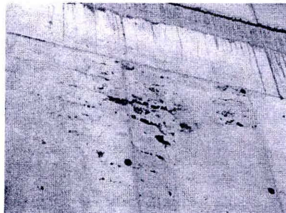
10. kép Fészkes beton
