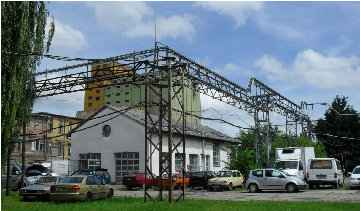
Tartószerkezeten vezetett 10 kV-os kábelek
