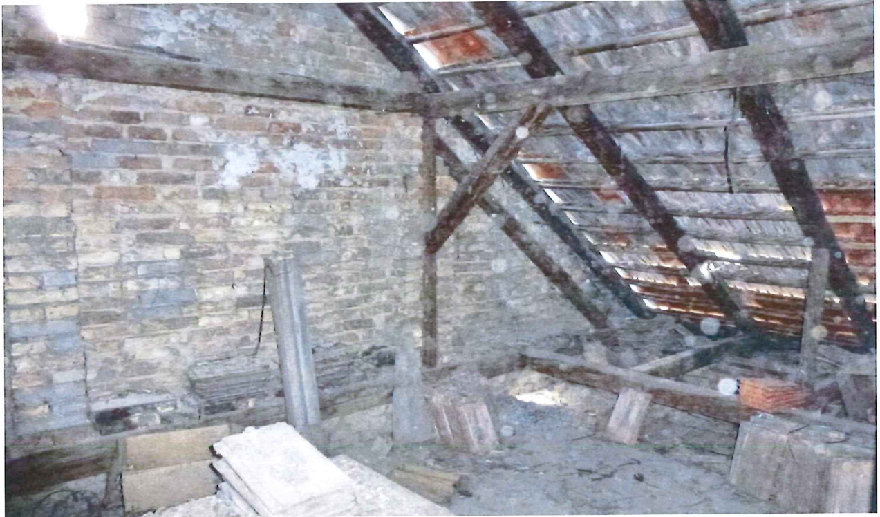
Tetőszerkezet udvari oldal. A padlástérben több helyen lomok, építőanyagok lettek felhalmozva.
