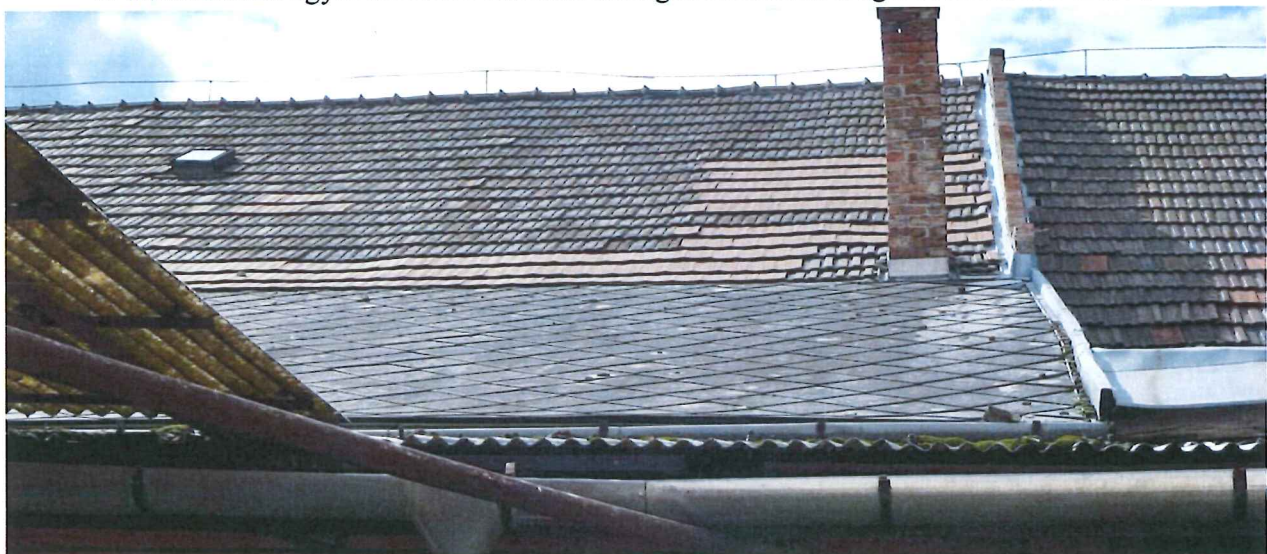
Udvari oldal. A kémények, bevilágító ablakok és tetőkibúvó környezetében a bádgozás, károsodott, a cserepek elmozdultak. A tető teljes felületén a lécezés és szarufák alakváltozása miatt hullámosság tapasztalható. A cserepezés részlegesen cserélt.
