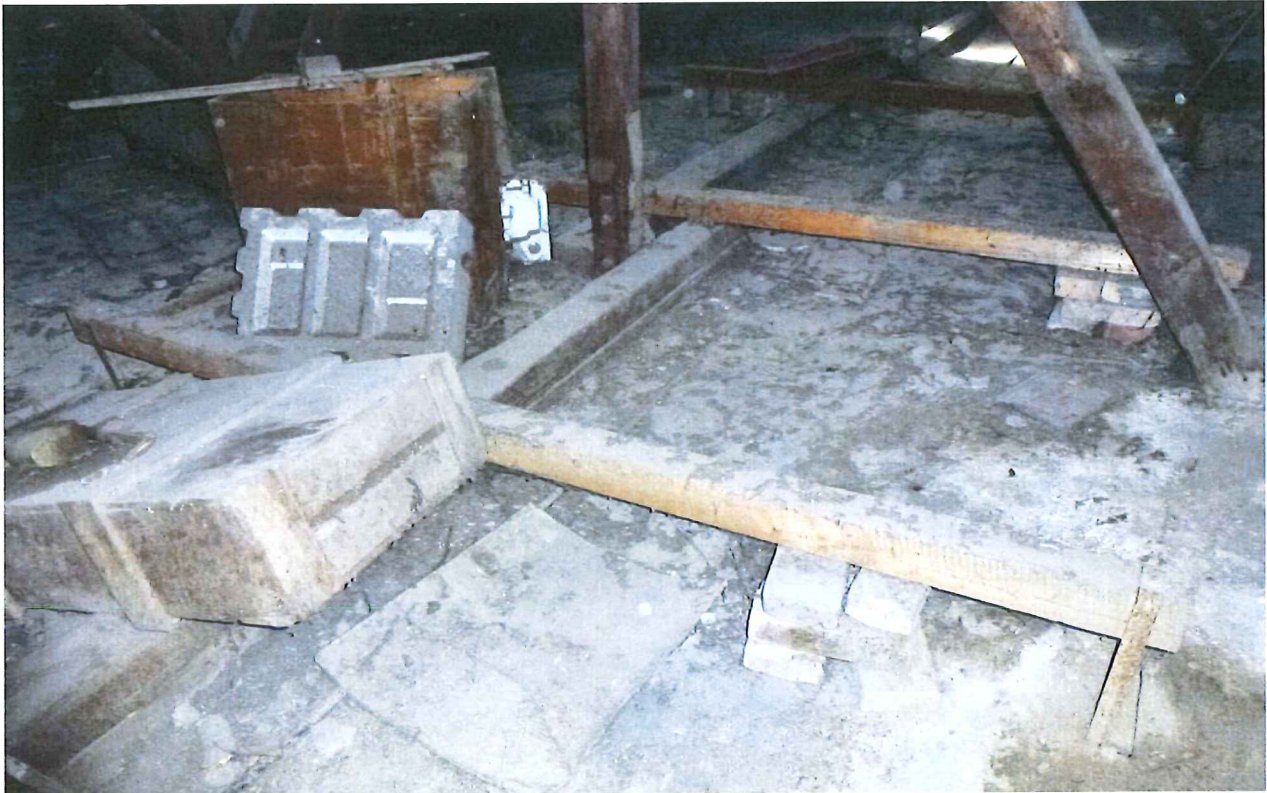
A tetőszerkezet egyik felében a fafödém utólagos felkötéses megerősítéssel lett ellátva.
