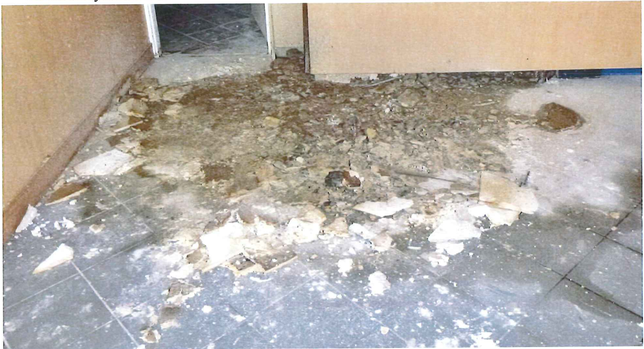
A belső térben több helyen (a beázásoknál) a fafödém károsodott. Az alsó részen a stukatúr átázott, és leszakadt. Sok helyen ezt az álmennyezet eltakarja.
