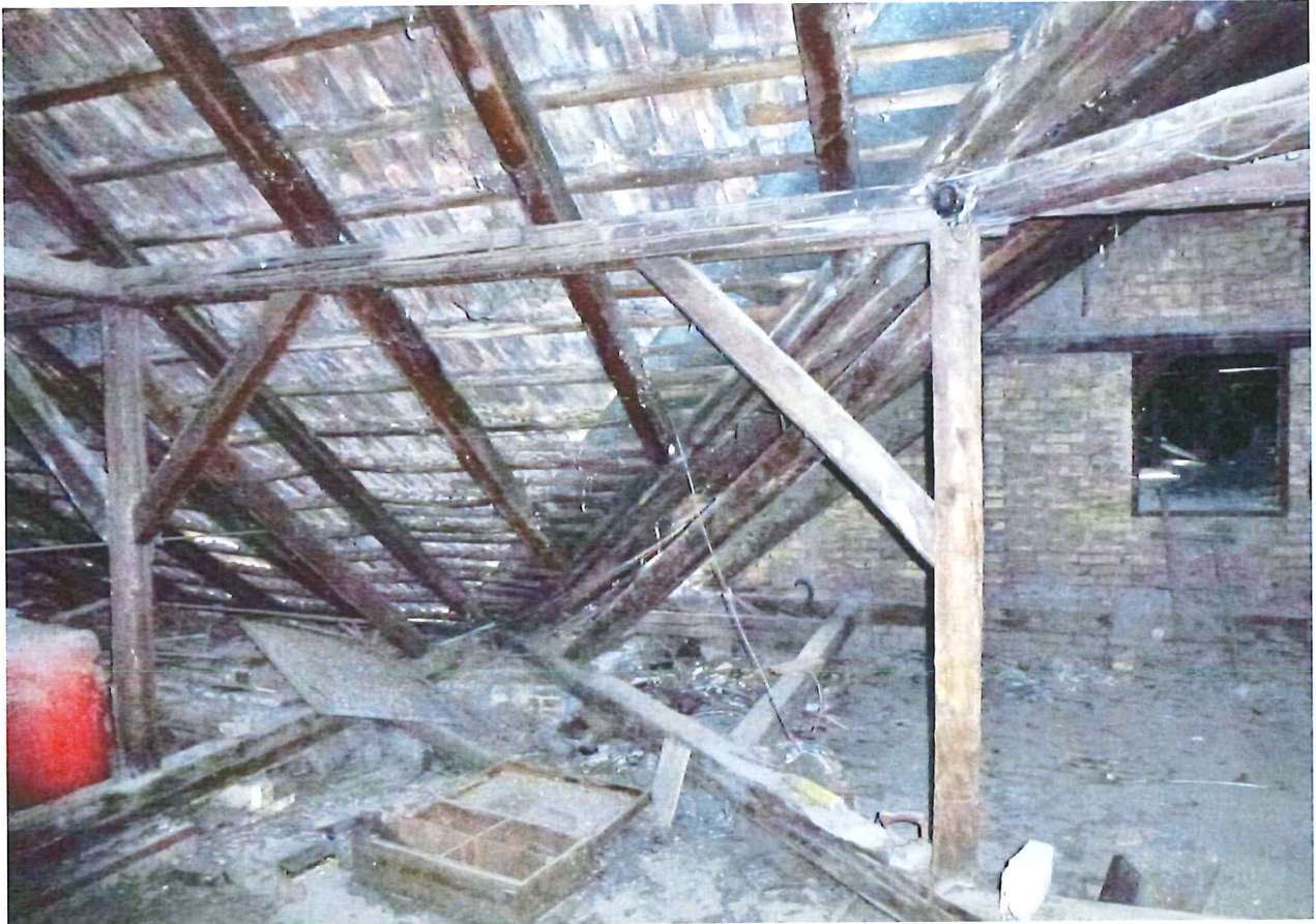
Udvari sarok rész. A faanyagokon beázásra utaló elszíneződések itt is vannak csak a kisebb fesztávok miatt nagyobb alakváltozások nem alakultak ki.
