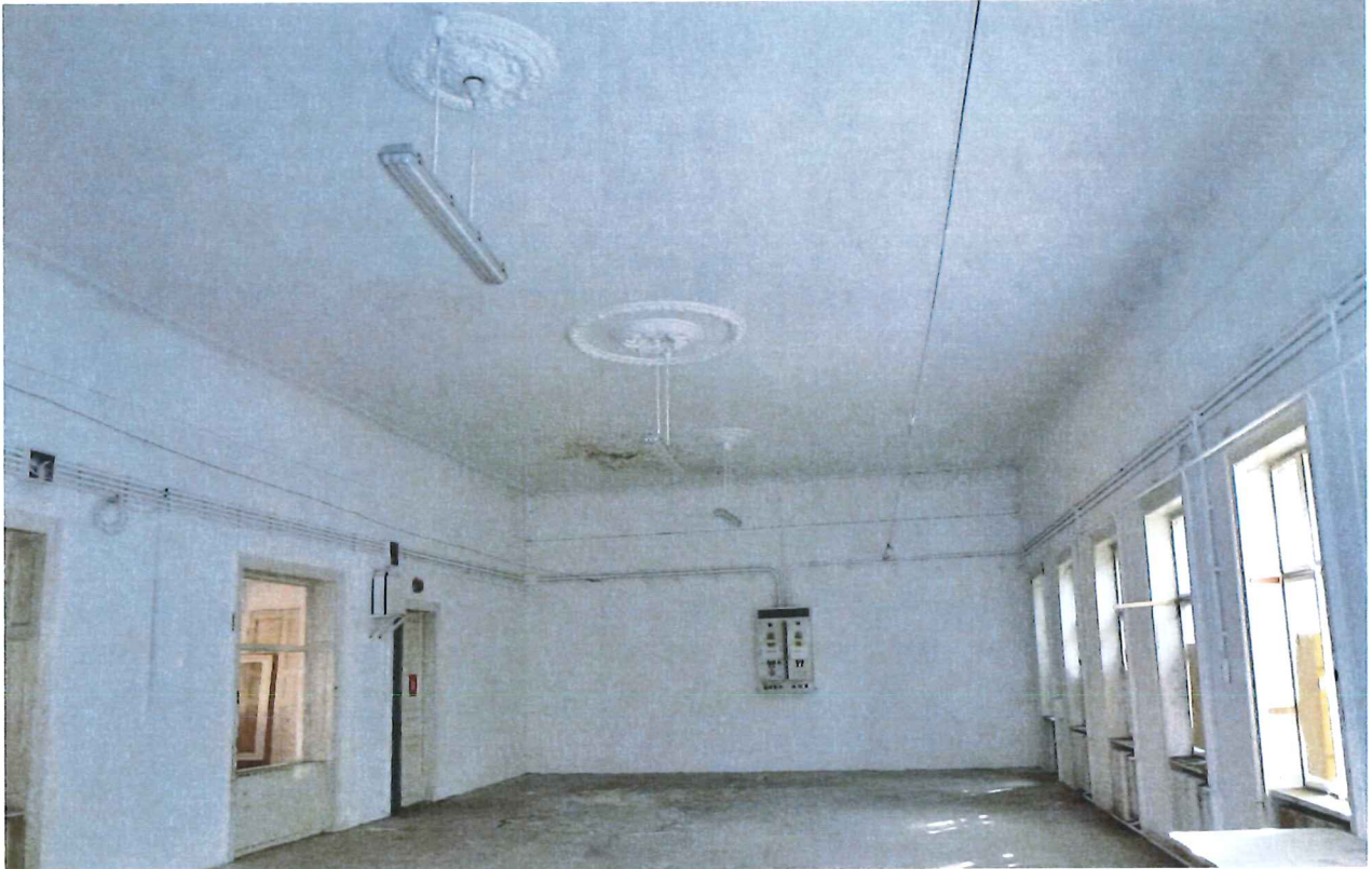
Károsodott födémrész. A beázás miatt a stukatúr, az álmennyezet és az oldalfal is átnedvesedett.
