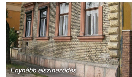
A lábazatok károsodásának oka lehet a nem megfelelő csapadékvíz elvezetés is.
